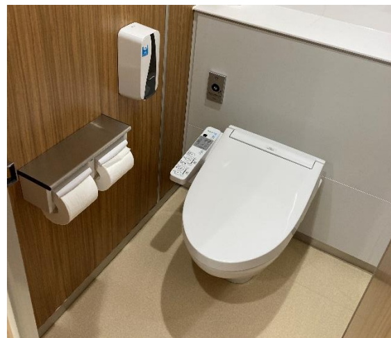
京阪神 瓦町ビル 節水型トイレ
