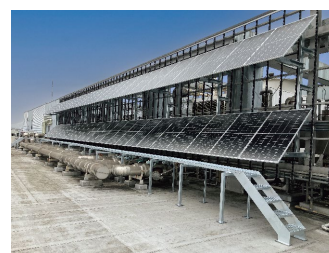
府中ビル 太陽光パネル
