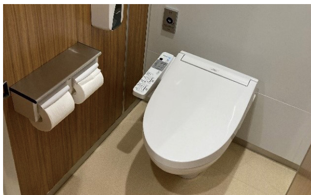
京阪神 瓦町ビル 節水型トイレ
