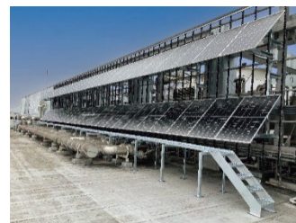
府中ビル 太陽光パネル
